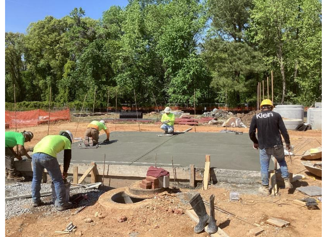
SOG para el equipo del edificio
