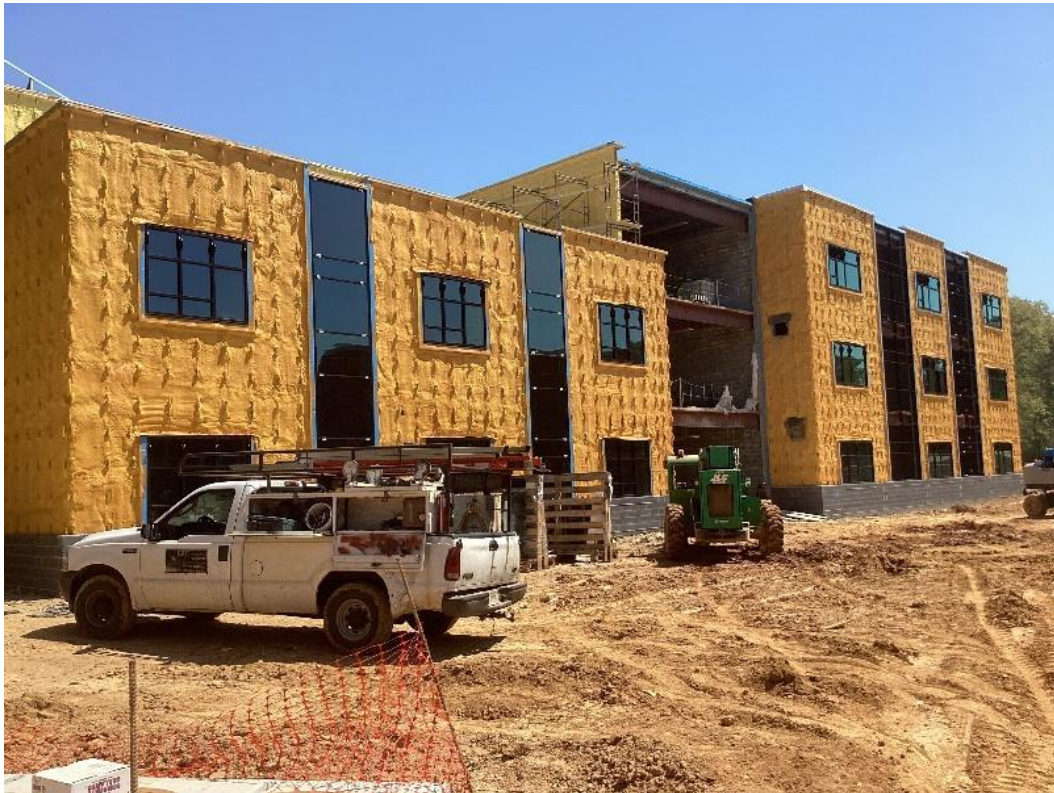
Área B y C : rociador de espuma, muro cortina, ventanas
