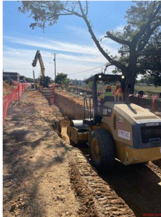
Tassement du sol à partir du trou d'homme (MH) 2 jusqu'au milieu de la route de raccordement ouest.
