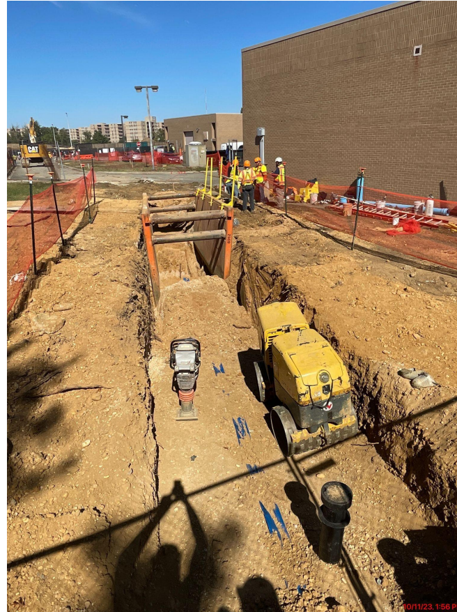
Tassement du sol au-dessus de la conduite d'eau
