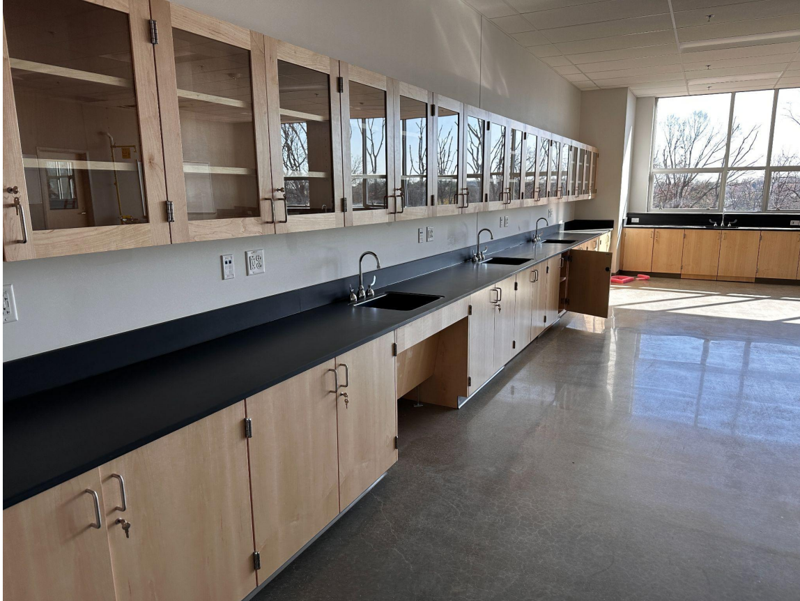
Gabinetes instalados en el salón de clase de ciencias
