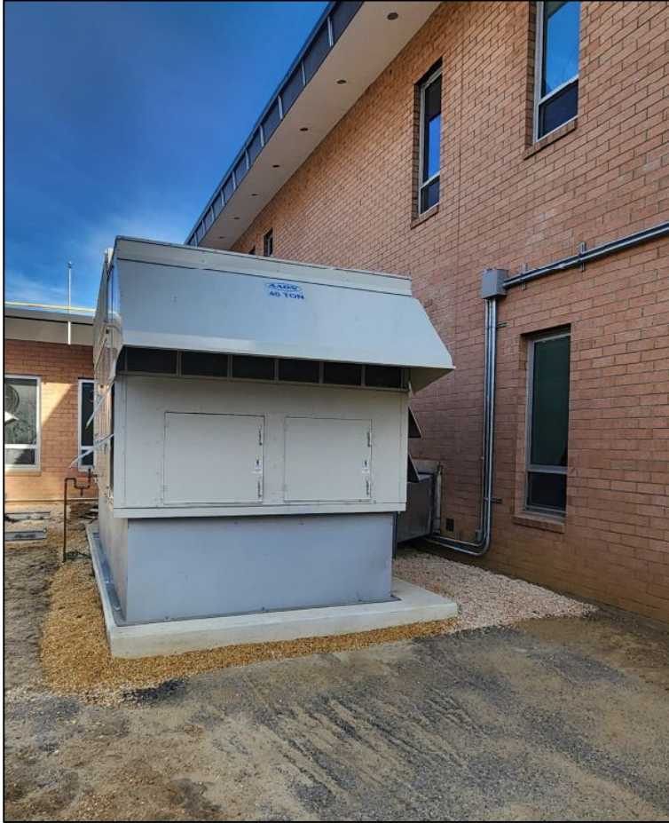
DOAS #1 instalado y encendido
