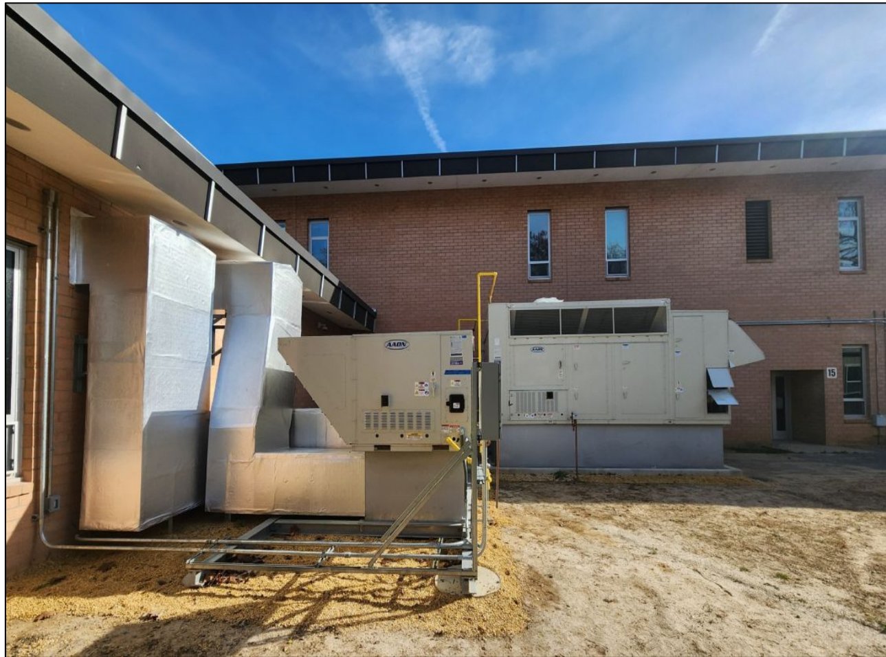
RTU#3 y DOAS #1 instalados y encendidos
