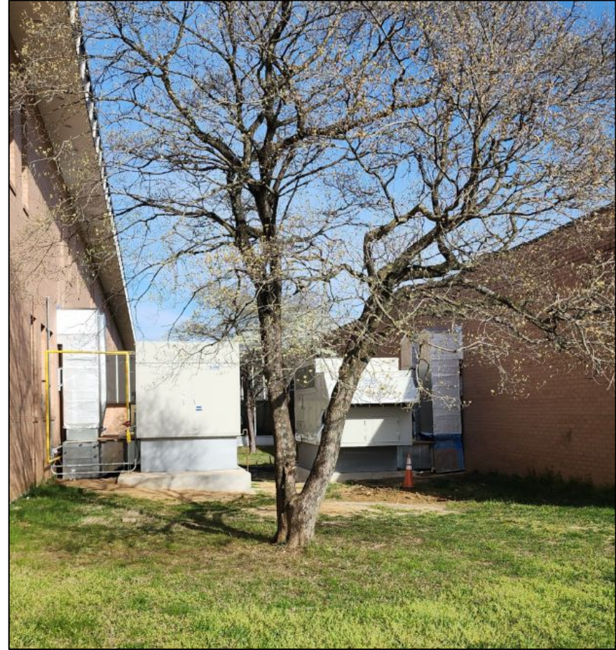
DOAS #2 y RTU instalados y encendidos
