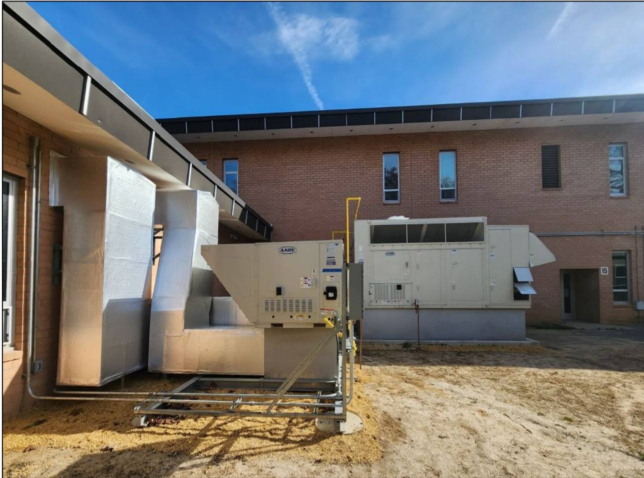
RTU #3 et DOAS #1 installés et mis en service
