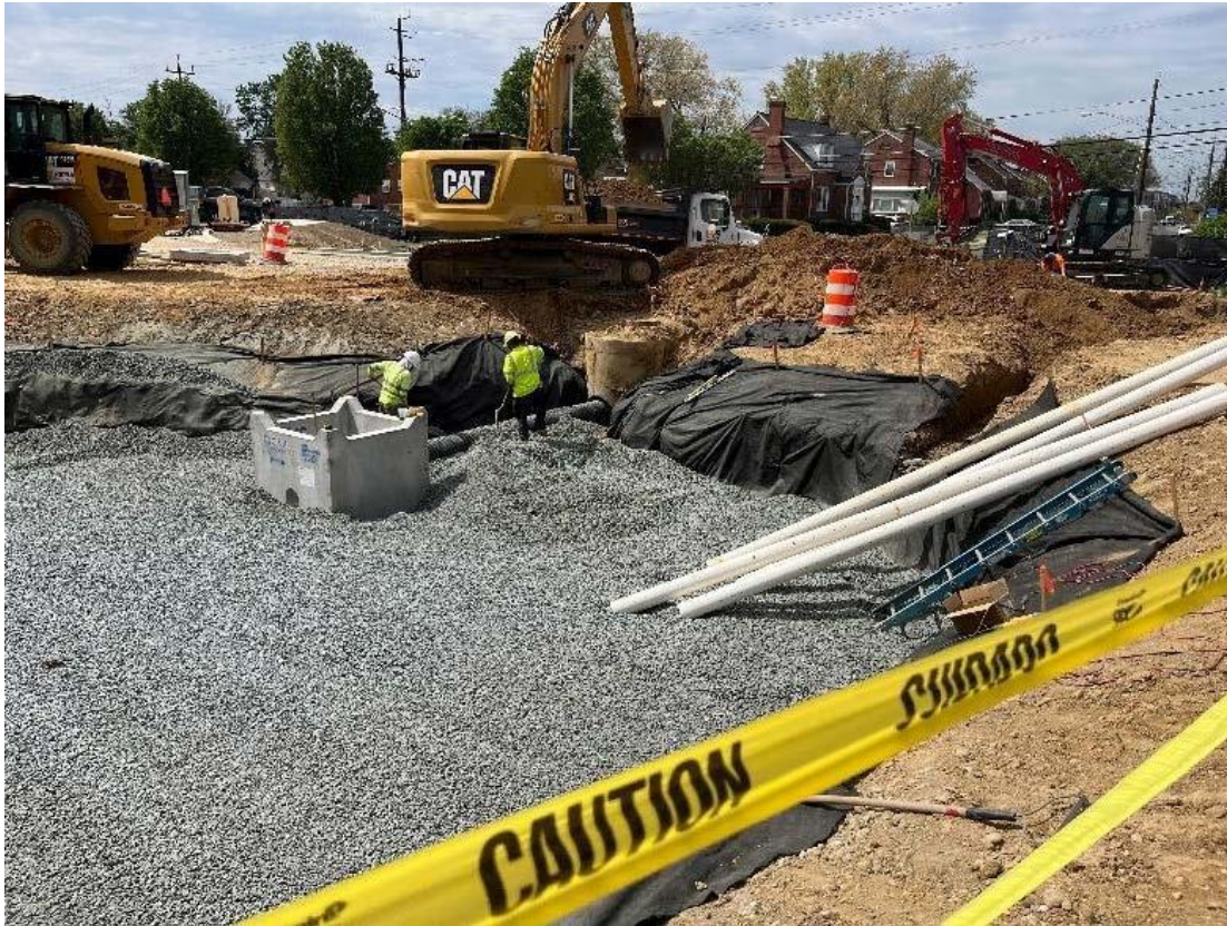
Gestion des eaux pluviales / Biorétention
