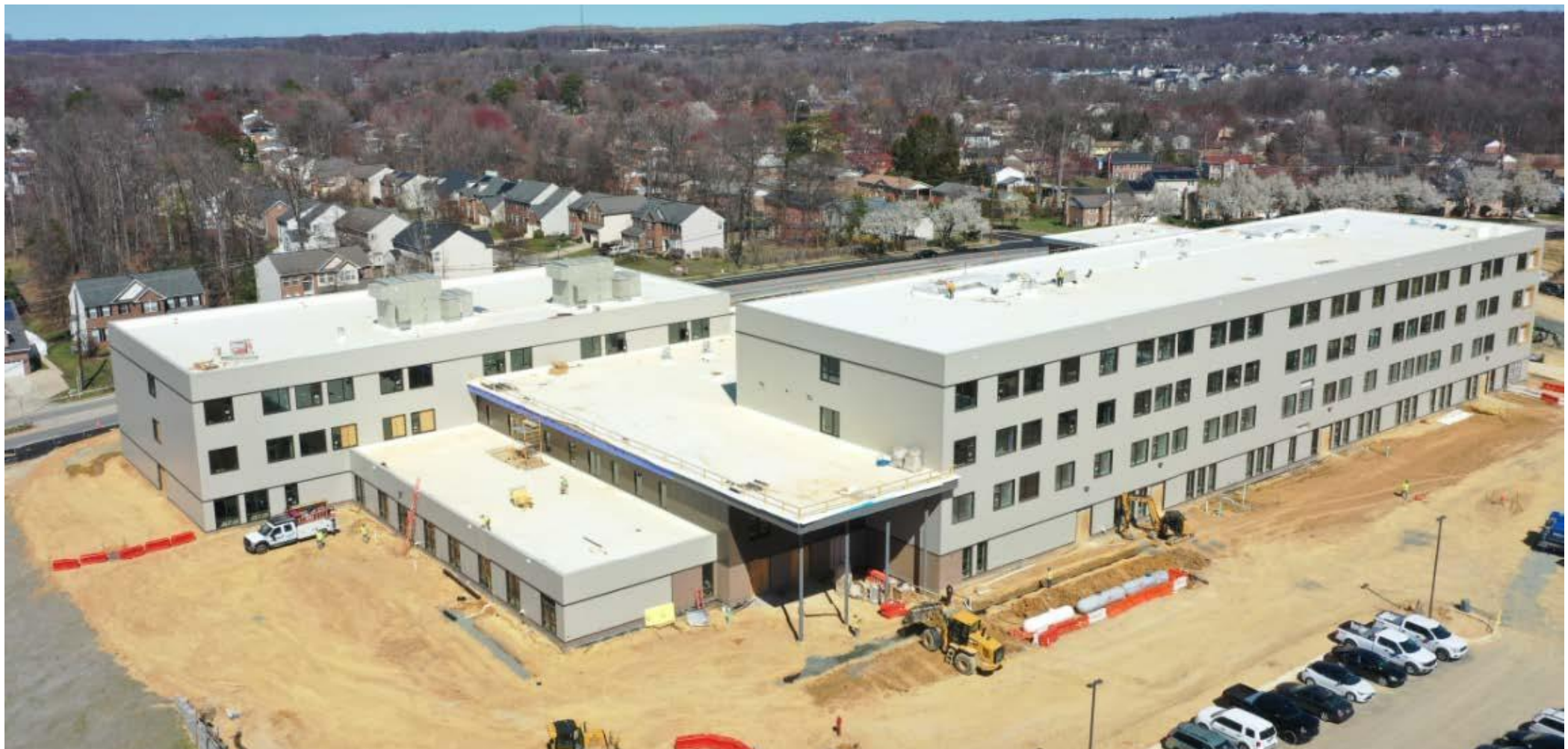
Vue aérienne de l'entrée ouest du bâtiment à la fin du mois de mars
